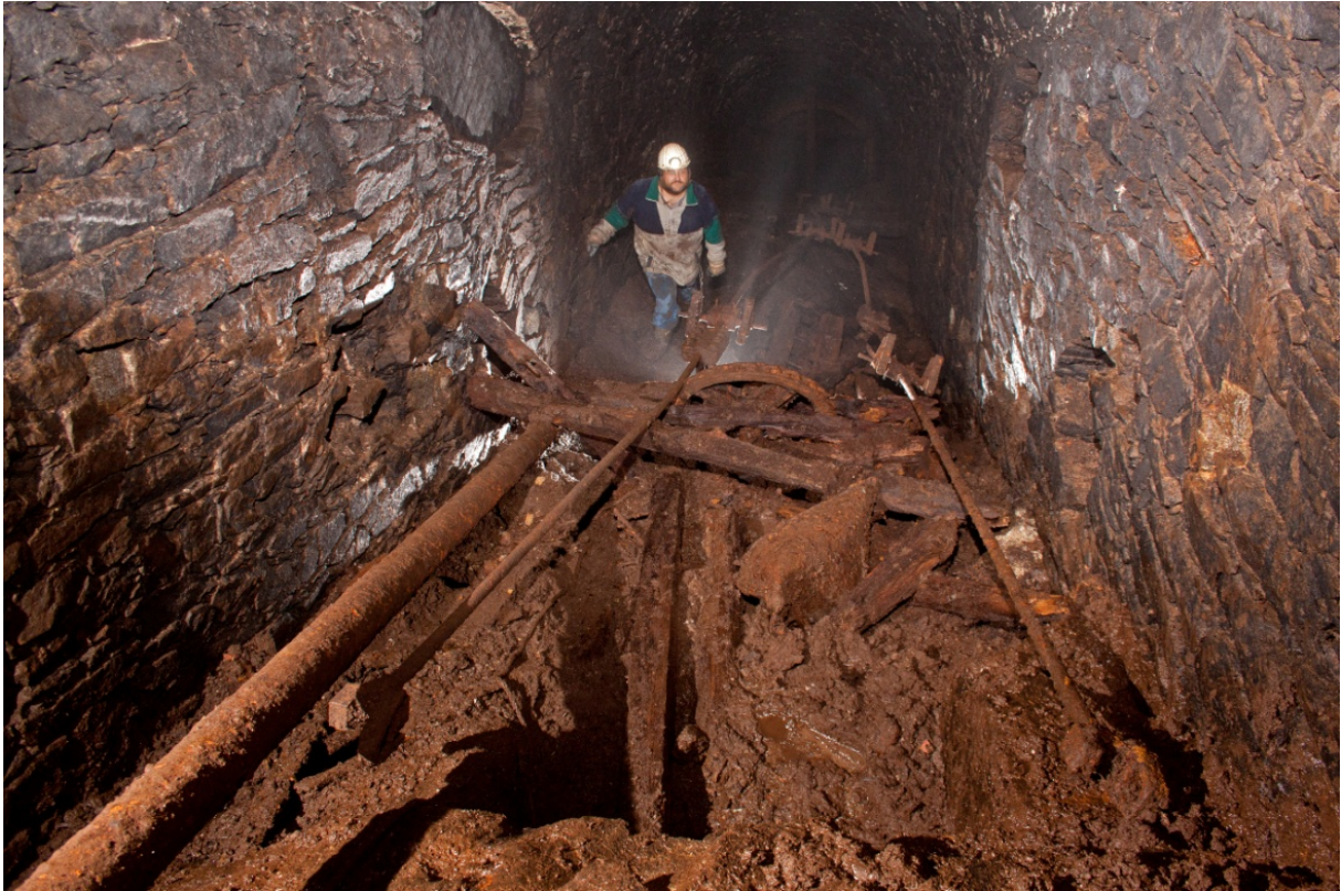
Abb. 8: Reste des Fahrkunstgestänges und des Kettenrades im Röschenschacht der Grube Beschert Glück. Foto: J. Kugler
